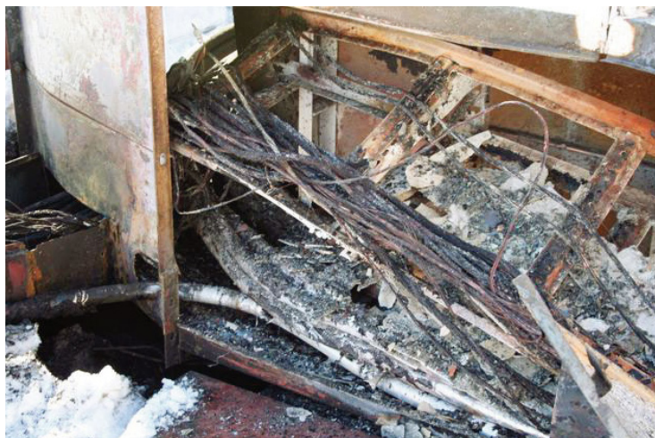
Рис. 4.1. Последствия пожара в кабельном коробе
