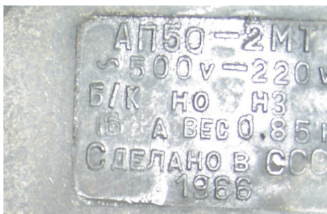
Рис. 4.59. Выработавшие эксплуатационный ресурс АВ. Защитная крышка автомата АП50-2МТ 1966 г. выпуска в цепях ШУ ЗРУ-10 кВ
