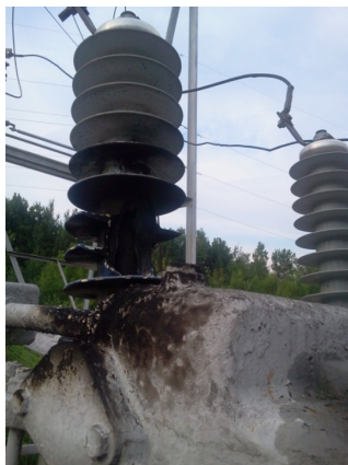
Рис. 2.1. Повреждение вводов от грозовых перенапряжений
