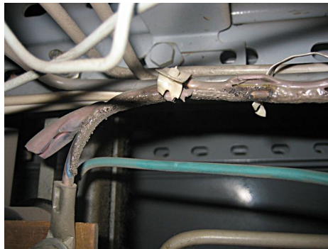
Рис. 4.65. Кабели с поврежденной (оплавленной) изоляцией в ЩПТ
