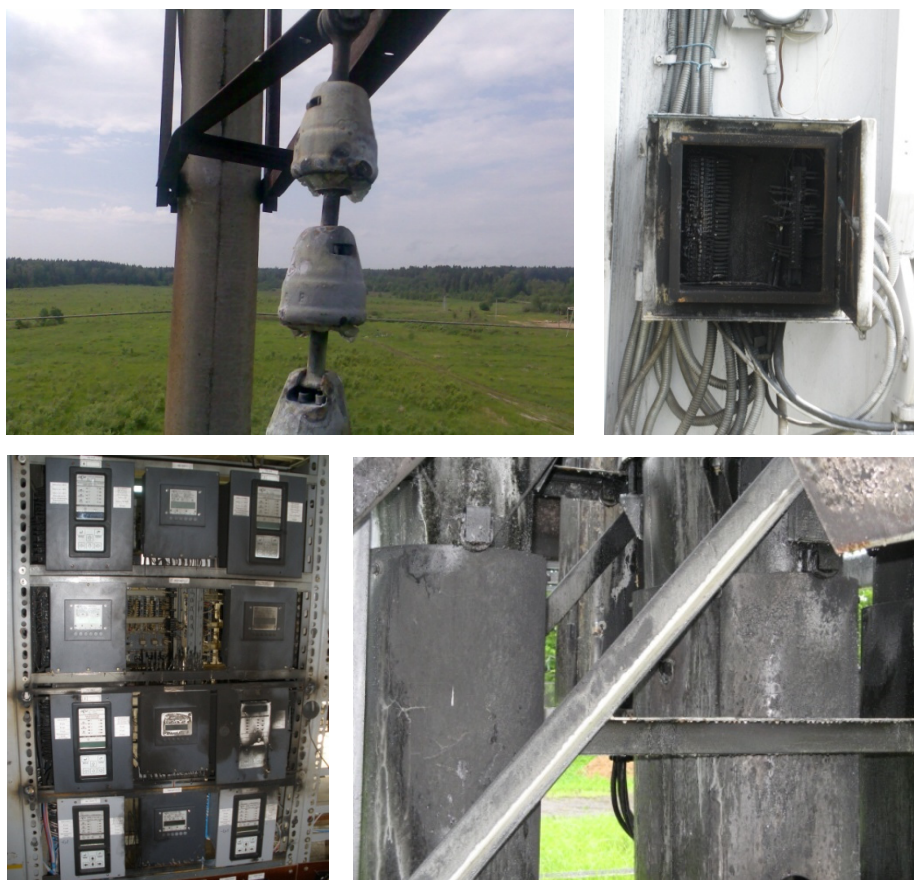
Рис. 2.3. Повреждение гирлянды изоляторов, вторичного оборудования и выключателя при ударе молнии в ВЛ
