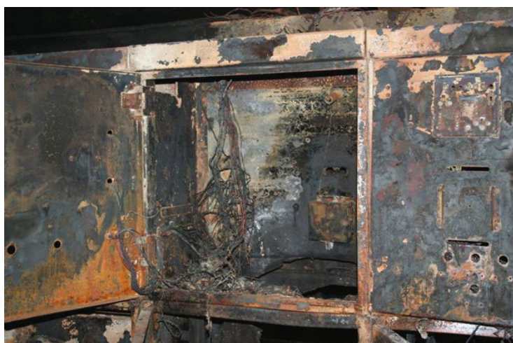
Рис. 4.2. Последствия пожара в КРУ-10 кВ
