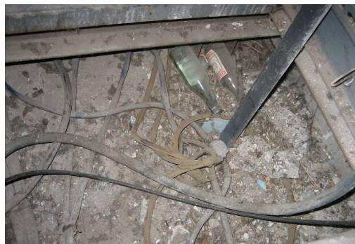
Рис. 4.66. Замусоренный кабельный канал в помещении ЩПТ
