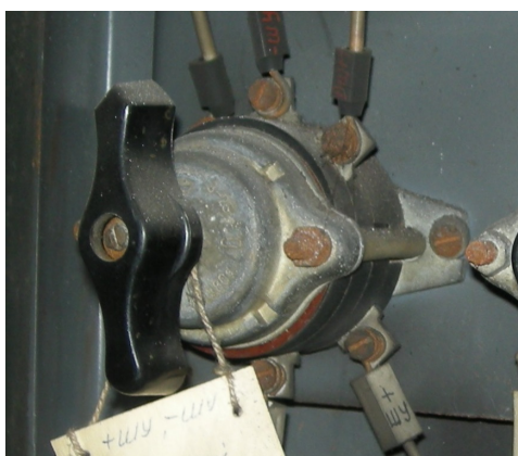
Рис. 4.51. Коррозия контактов секционного выключателя цепей ШУ в КРУ-10 кВ
