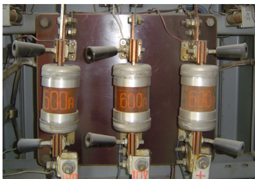
Рис. 4.61. Вводные предохранители типа ПР-2 (~220В), не предназначенные для работы в установках постоянного тока (короткий типоразмер, не отключают дугу)
