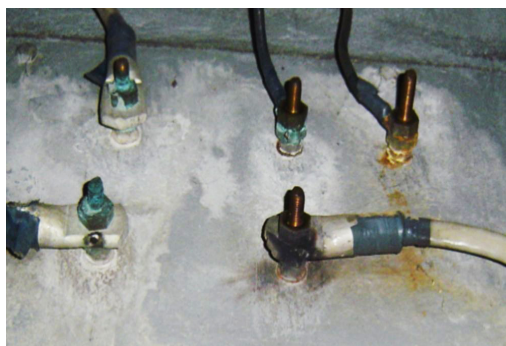
Рис. 4.48. Окисленные контакты на проходной доске внутри помещения аккумуляторной ПС
