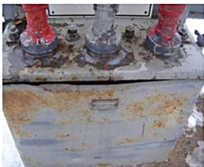
а) шкаф привода
