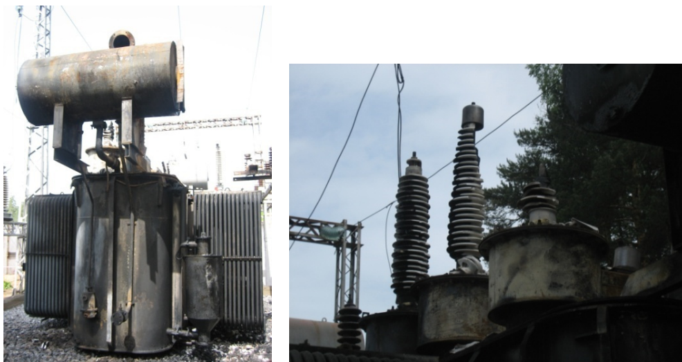
Рис. 2.2. Повреждение трансформатора от обратного перекрытия при ударе молнии в молниеотвод
