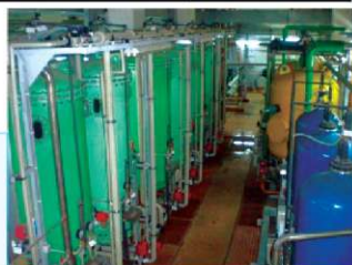
Рис. 9.12. ВПУ на ПГУ РТС «Строгино»
