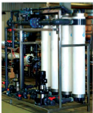
Ноябрьская ПГЭС Установка ультрафильтрации
