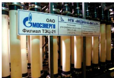
Установка ультрафильтрации производительностью 400 м 3 ·ч -1
