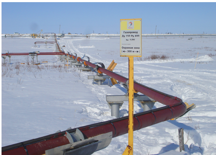
Рис. 3.66. Обогреваемый трубопровод и смонтированная на нем ИРСН
