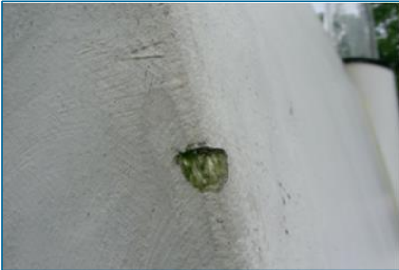
Рис.72. Повреждённая отделка со стеклянными волокнами (фото: Piero Medici, 2011)
